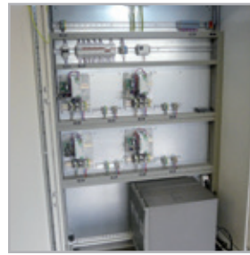
UPS-Kast t.b.v. OK lampen
