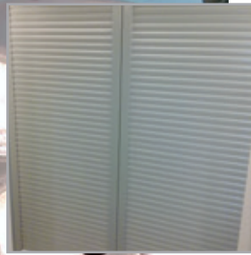
Ruimtegebrek? Trafokast met rolluiken!
