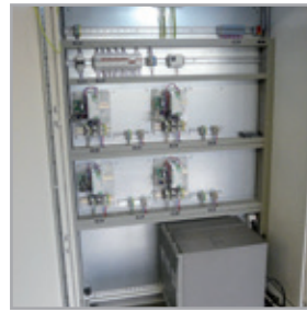
UPS-Kast t.b.v. OK lampen
