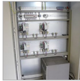
UPS-Kast t.b.v. OK lampen
